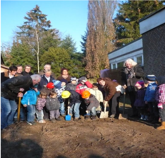
Am 06. März 2012 erfolgte der erste Spatenstich für unsere Krippe in der Friedrichstraße
